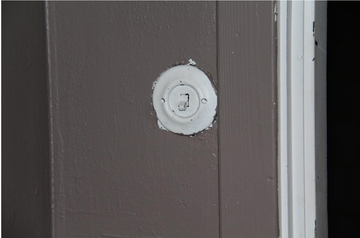
Foreldet elektrisk anlegg
