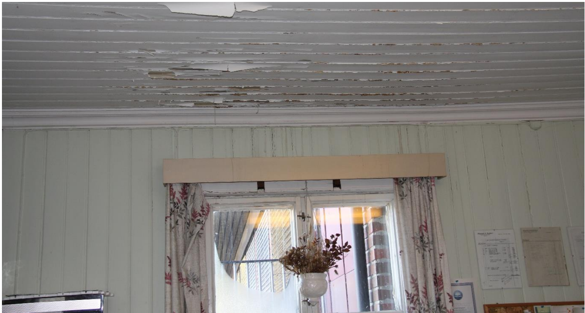
Lekkasjeskader i himling 2. etasje
