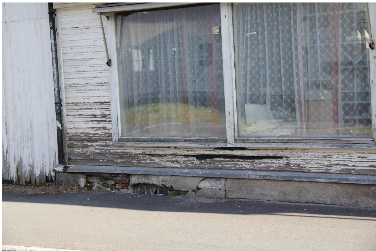
Råteskader på utvendig panelkledning
